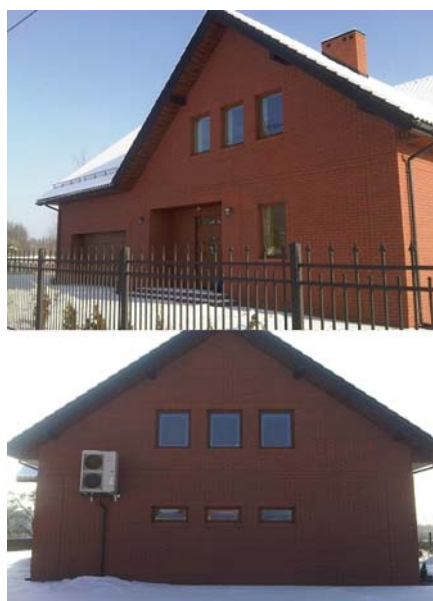
Rys. 1. Instalacją referencyjną jest system grzewczy z pompą ciepła działający w domu jednorodzinny o powierzchni 250 m 2 , pod Białymstokiem
