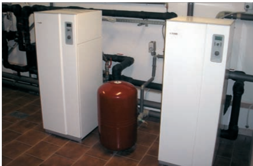
Kaskada dwóch gruntowych pomp ciepła NIBE™ F1330-60 kW o łącznej mocy 120 kW zainstalowana w Klasztorze Sióstr Karmelitanek Bosych w Bornym Sulnowie
